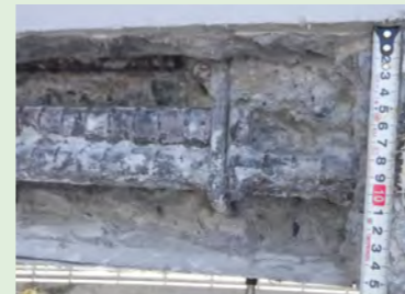
補修20年経過後の鉄筋状況 (海岸沿いの橋梁の桁)
